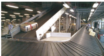
▲ 手荷物搬送設備
