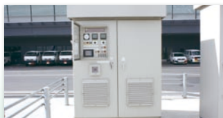
▲電力変換装置
