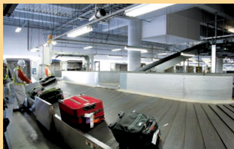
手荷物搬送設備
