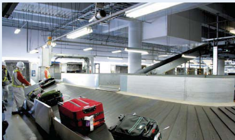
手荷物搬送設備
