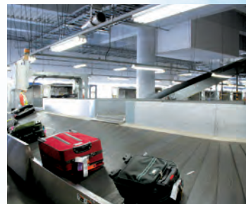
手荷物搬送設備
