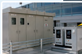
固定式電力供給設備
